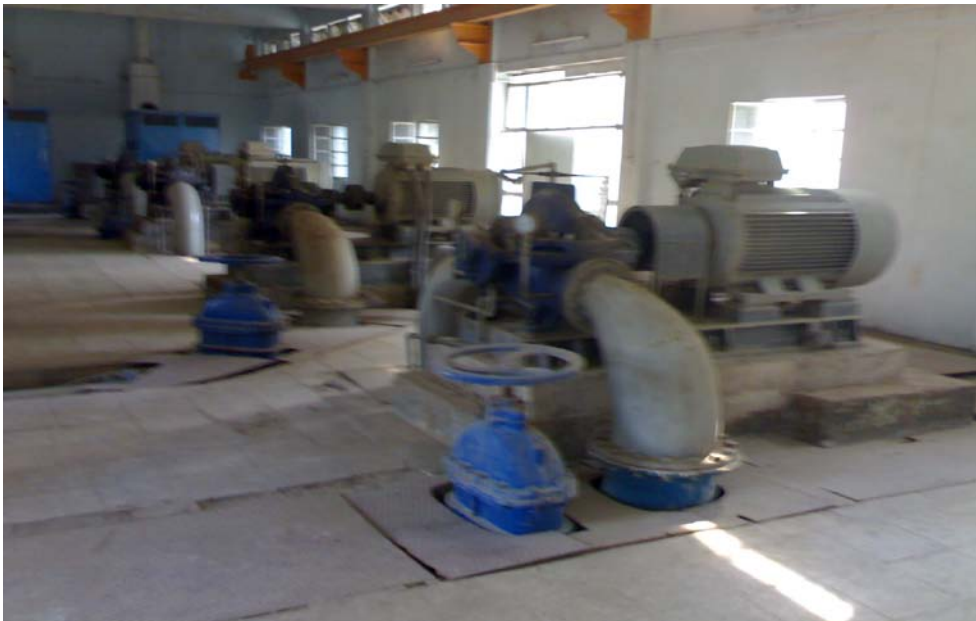
صورة (2) محطة الضخ
